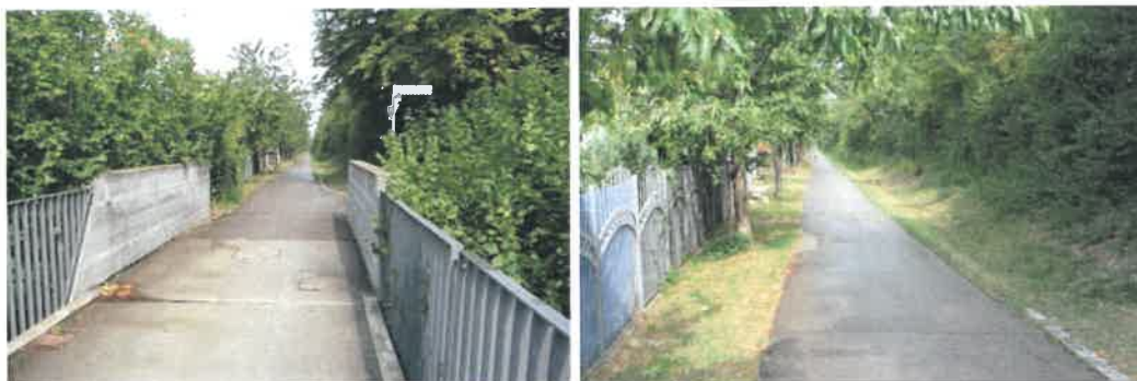
Abbildung 15: Trassenverlauf der Regional-Stadtbahn auf alter Trasse, Blick von der Brücke über die Große Heerstraße in Richtung Pfullingen Bahnhof mit dem nördlichen Widerlager (links) und Detailaufnahme des Bereichs der neuen Haltestelle (rechts).
