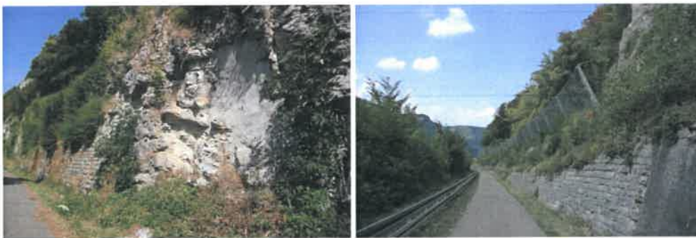
Abbildung 51: Hangsicherungen an der Honauer Steige. Ausmauerung und Spritzbetonsicherung (links), Ausmauerung und dynamische Fangzäune (rechts). Blickrichtung Unterhausen
