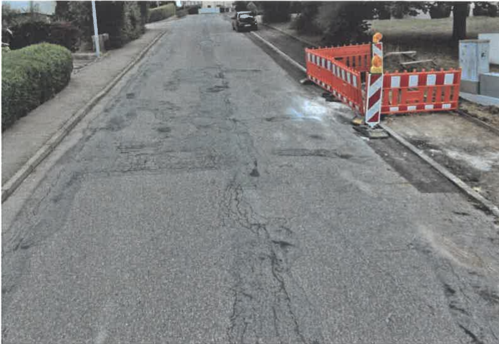
Albstraße (Setzungen, Risse, Flicke)
