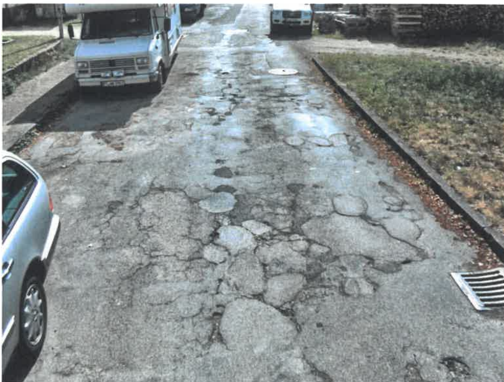
Sternbergstraße (Setzungen, Risse, Flicke)
