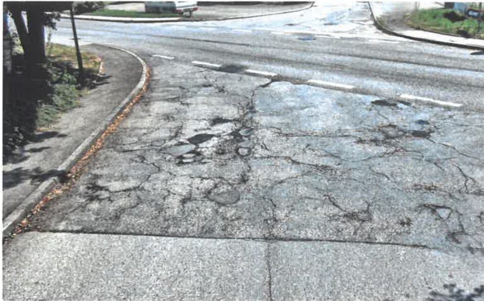
Lindenstraße (Setzungen, Flicke, Risse)
